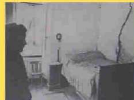
Dégât sur bâti à Sévignacq-Meyracq (64) suite au séisme d'Arudy en 1980 (© Sud-Ouest)
